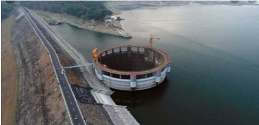
Gambar No. 6 - Bendungan PLTA Jatiluhur (186 MW), Tipe Reservoir Multipurpose, Operasional kebutuhan irigasi, untuk Pemasok Beban Dasar
